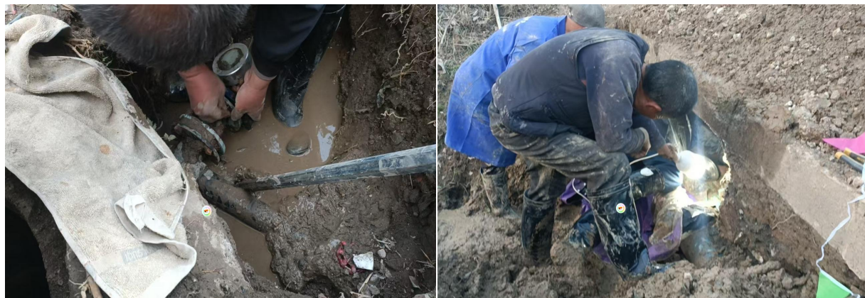
图 3-6 盐河街道现状供水管道维修现状
