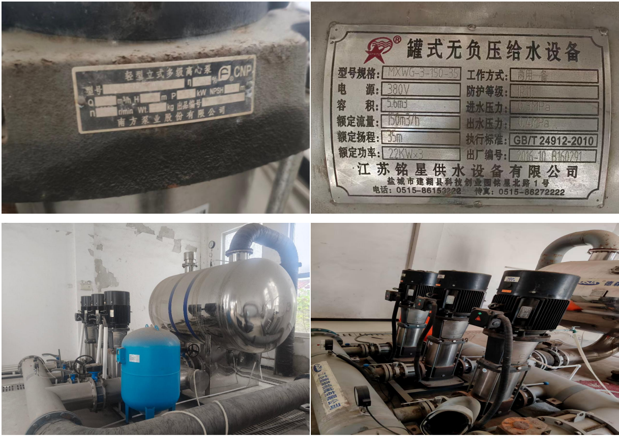
图 3-12 现状增压站设备图
