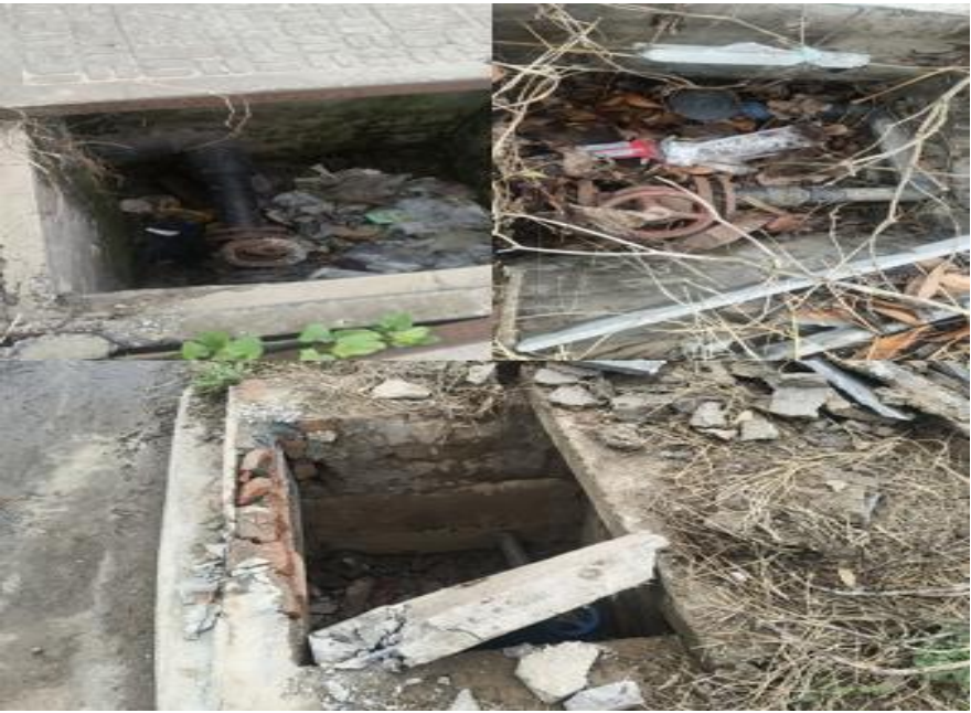
图 3-11 现状水表井破损图
