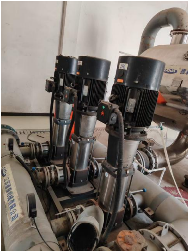
图 4-26 和平镇现状增压站图
